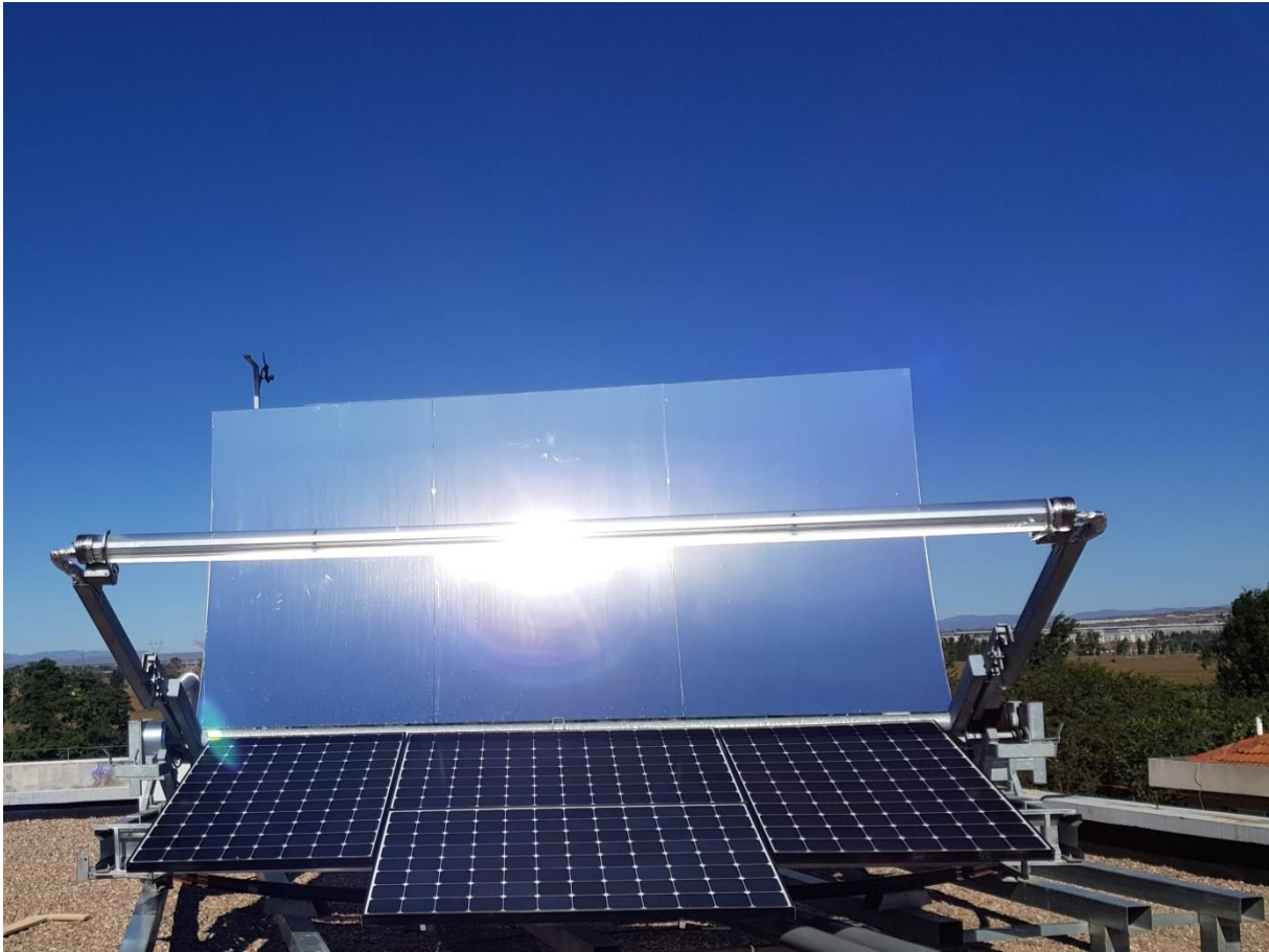
SunOyster 16 heat pvplus auf einem Schulgebäude in Zhangjiakou, Hebei province, ca. 150 km nordwestlich von Peking. Sie erzeugt neben Strom heißes Trinkwasser für Schüler und Lehrer.
